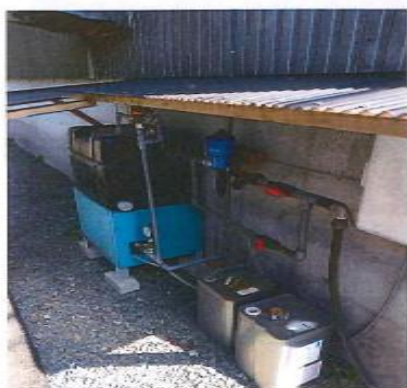
Một bể chứa nước giếng và một máy bơm để phun nước
