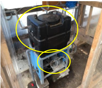
Một bể chứa nước giếng và một máy bơm để phun nước
